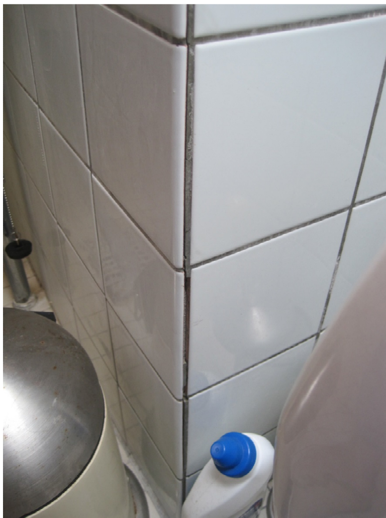
Foto 6. Revne i fuge mellem skunkvæg og skillevæg.
