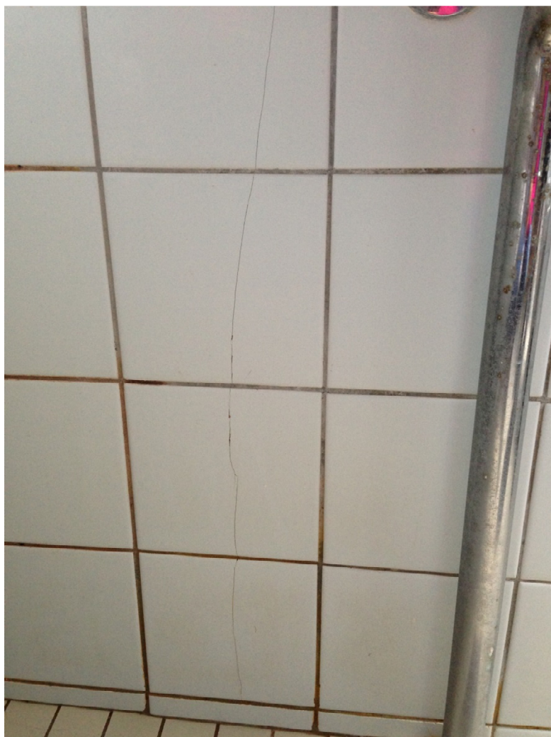
Foto 7. Revner i fliser.
