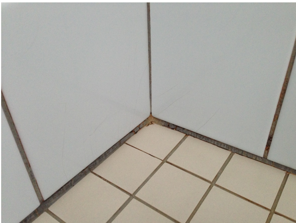
Foto 4. Defekt fuge mellem gulv og væg.
