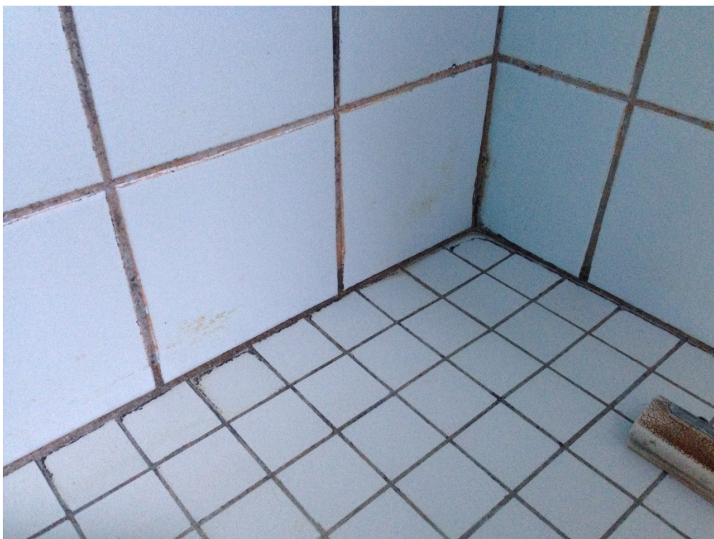
Foto 2. Skimmelvækst på fuger i flisebeklædning.
