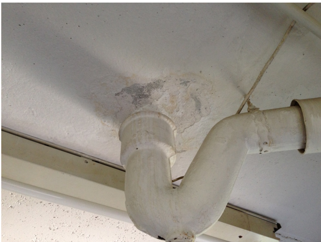
Foto 10. Fugt og udfældninger, afskalning af maling i loft under badeværelse.
