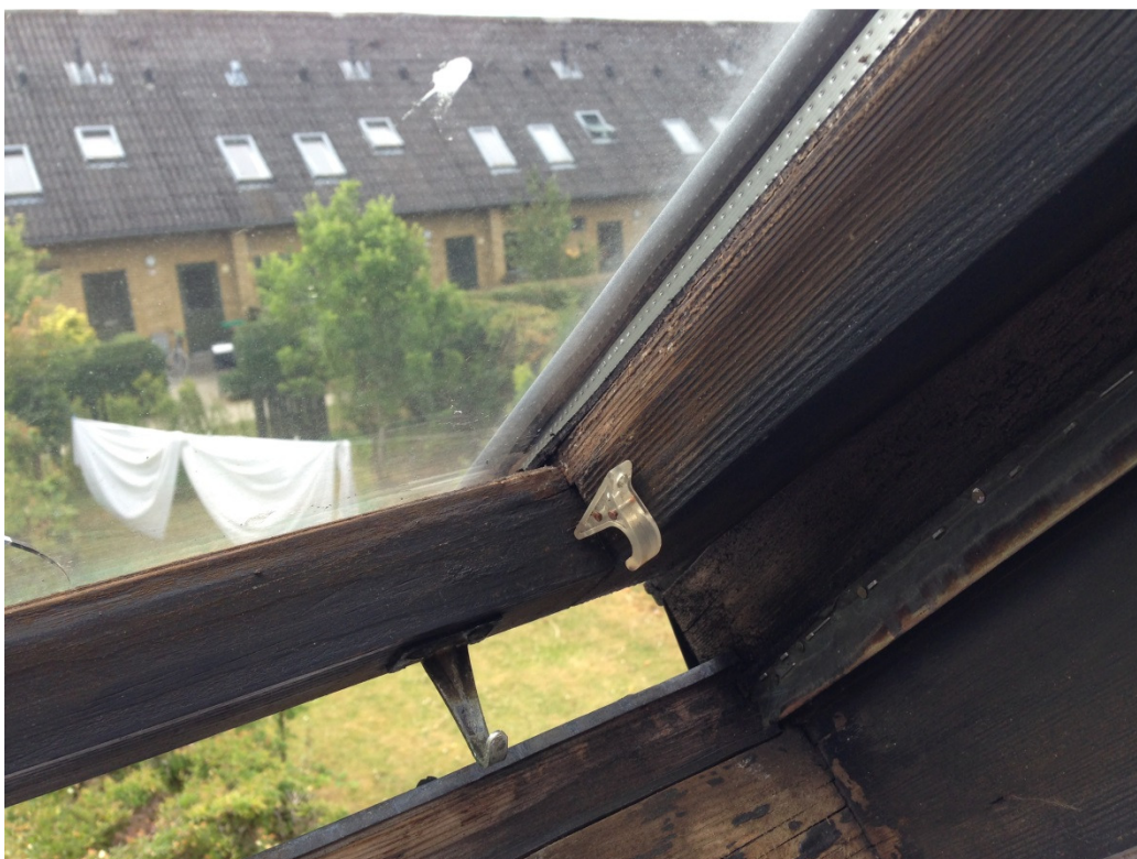
Foto 8. Glasfuge er mørnet væk.
