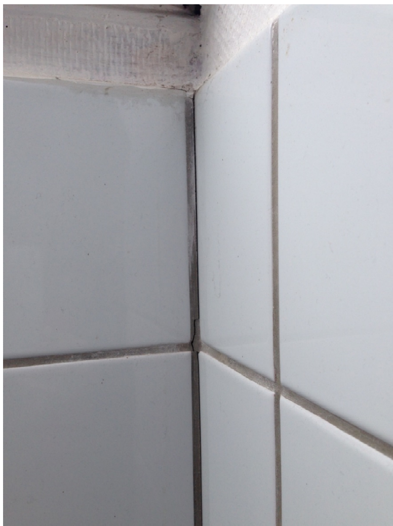
Foto 5. Revne i fuge på hjørne.
