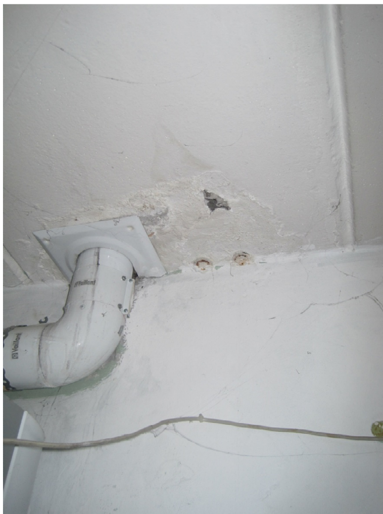
Foto 11. Fugt og udfældninger, afskalning af maling i loft under badeværelse.
