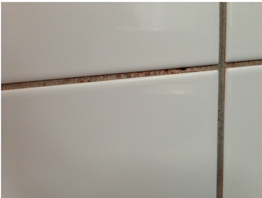
Foto 3. Huller og skimmelvækst på fuger i flisebeklædning.
