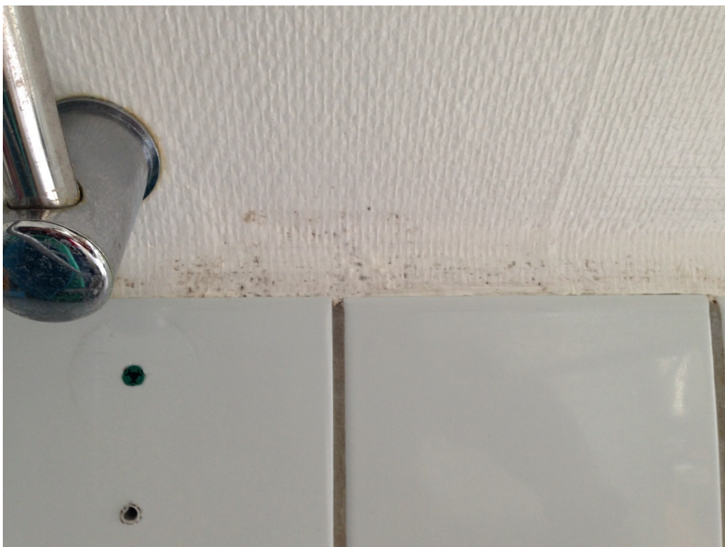
Foto 9. Skimmelvækst på væg over fliser.
