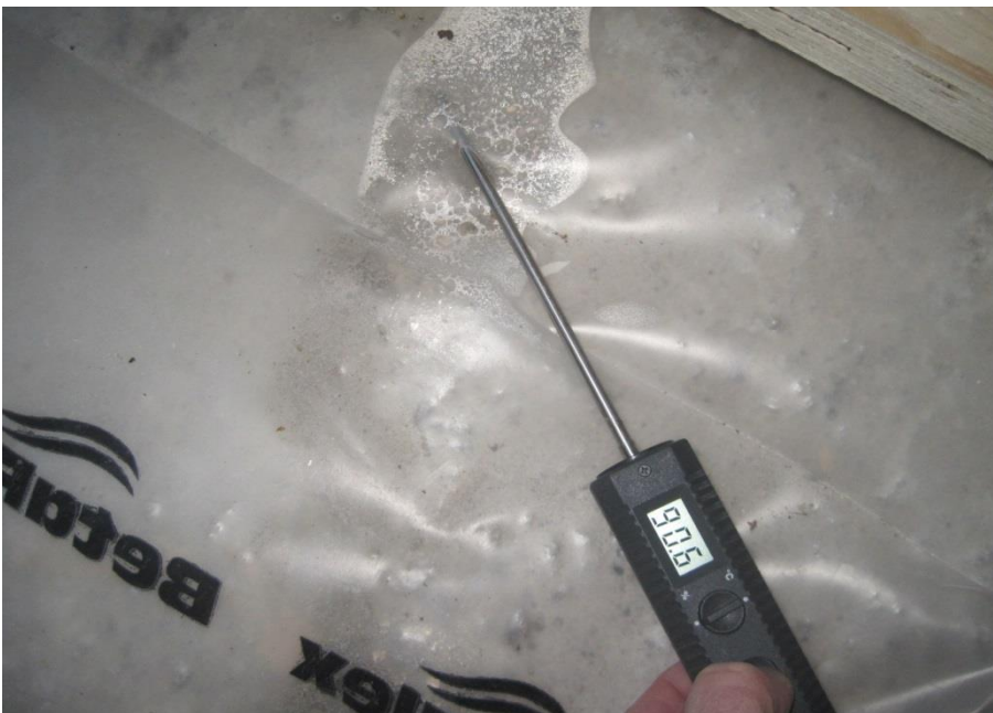
Foto: Høj relativ luftfugtighed under PE-folie i køkkenområde.
