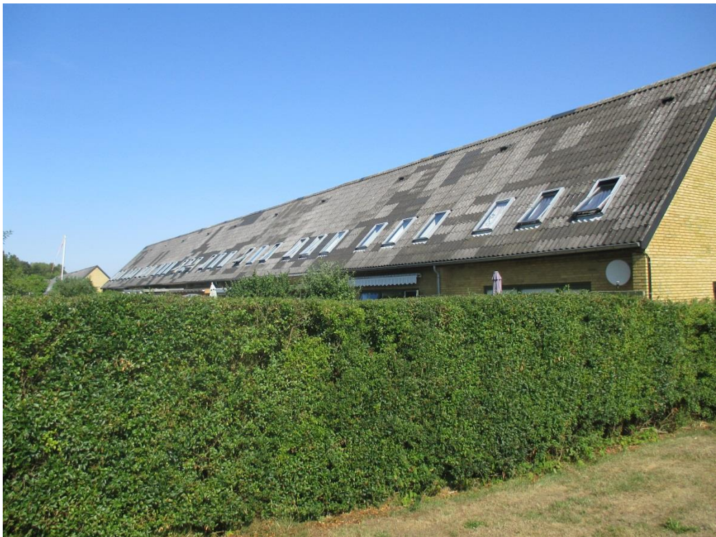
Foto 13. Mange tagplader er udskiftet i tagfladen, specielt omkring tagvinduerne.
