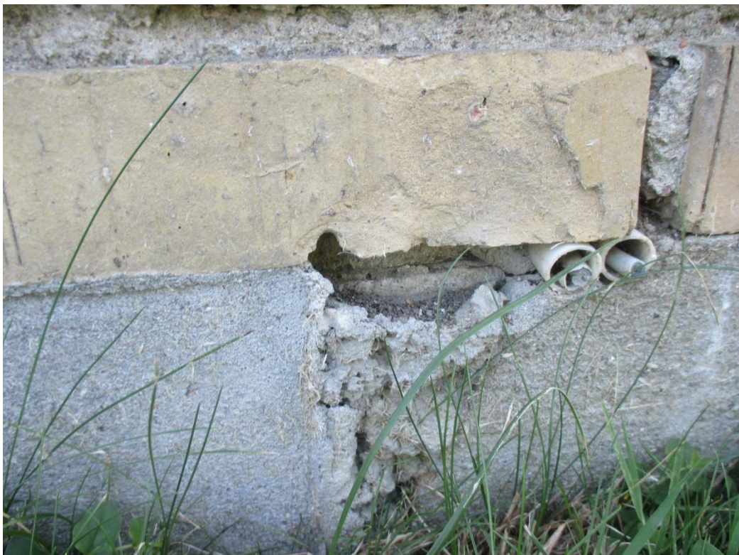
Foto 5. Dårligt udfyldte fuger
