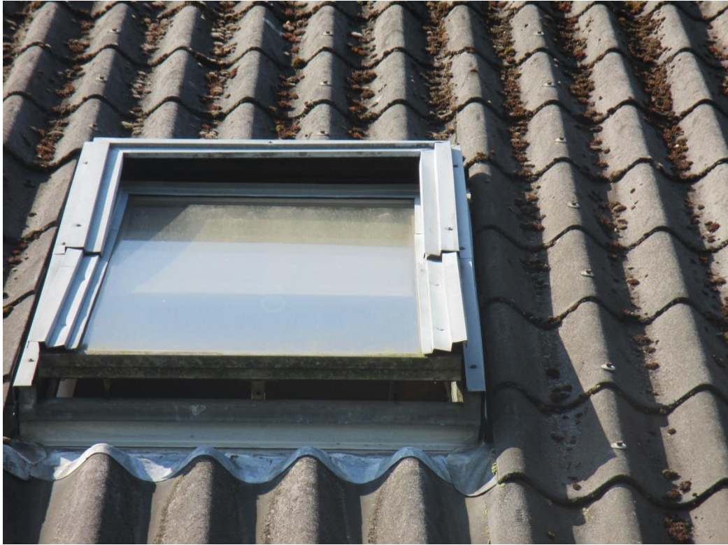
Foto 14. Tagplader ligger tæt på tagvindue.
