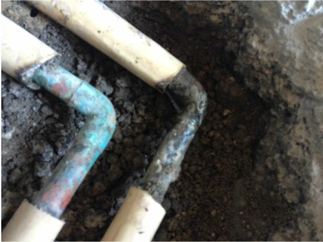
Foto 19. Brugsvandsrør indstøbt i betondækket. Kobberrør.
