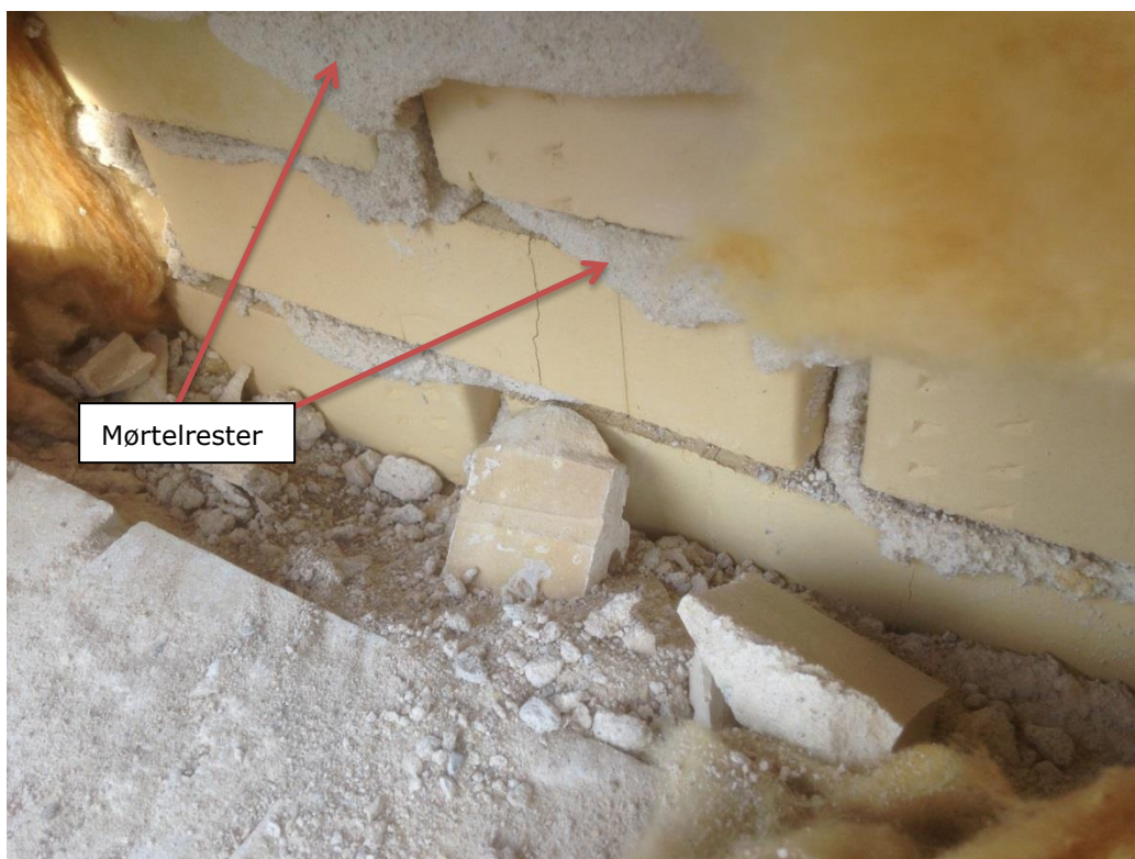
Foto 10. Manglende afskrabning af mørtel.
