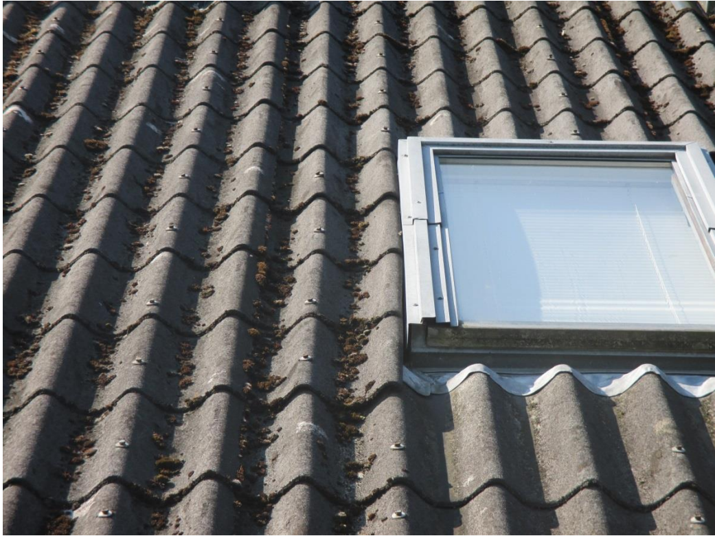
Foto 12. Mos og algevækst på tagfladen.
