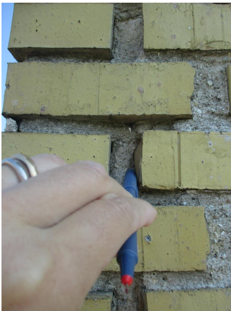
Foto 1. Dårligt udfyldte fuger
