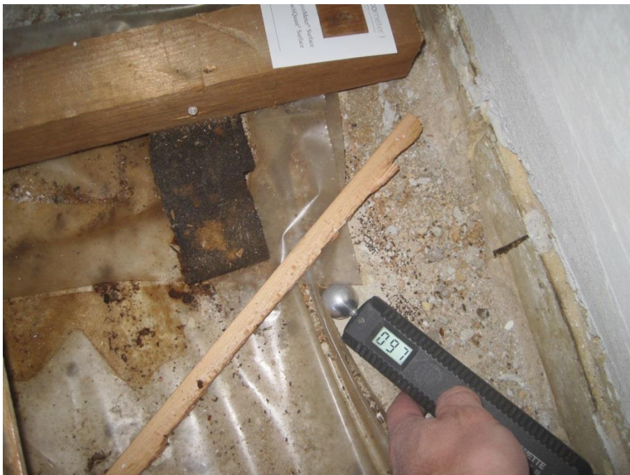
Foto: 97 enheder på Gann-måler, indikerer en høj opfugtning af betondæk i stue.
