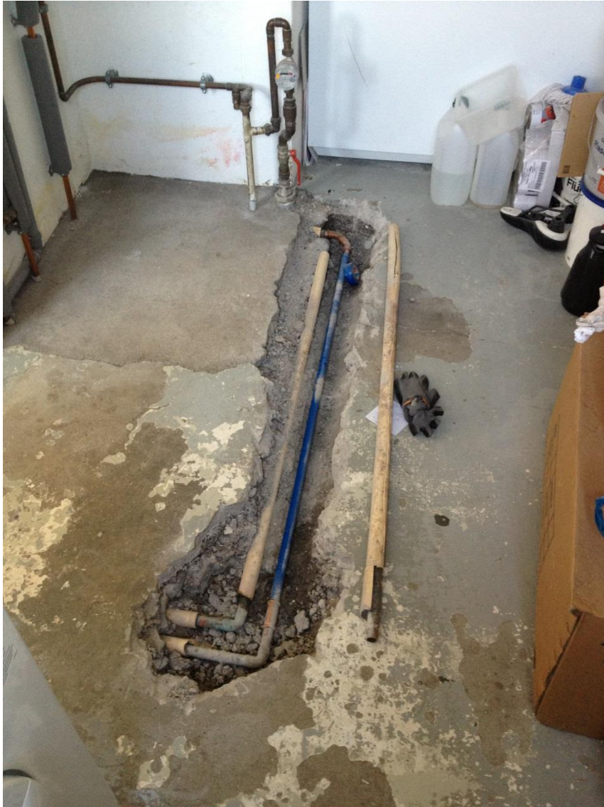
Foto 18. Brugsvandsrør indstøbt i betondækket. Kobberrør.
