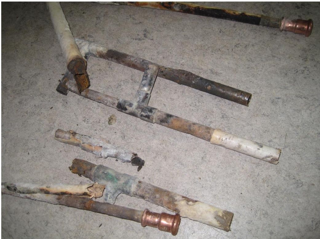
Foto 17. Udskiftede brugsvandsrør. Kraftig tæring på rør. Isolerede stålrør med kobberfittings.
