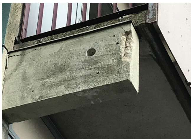
Eksempel på revnede betonkonsoller
