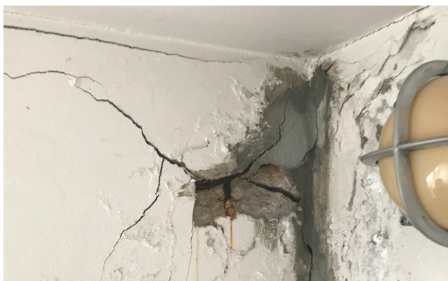
Eksempel på revner i beton
